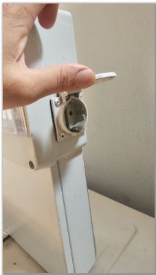
Toma corriente encastrada
