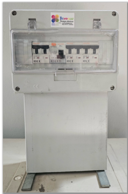
Cuadro eléctrico 400 W
